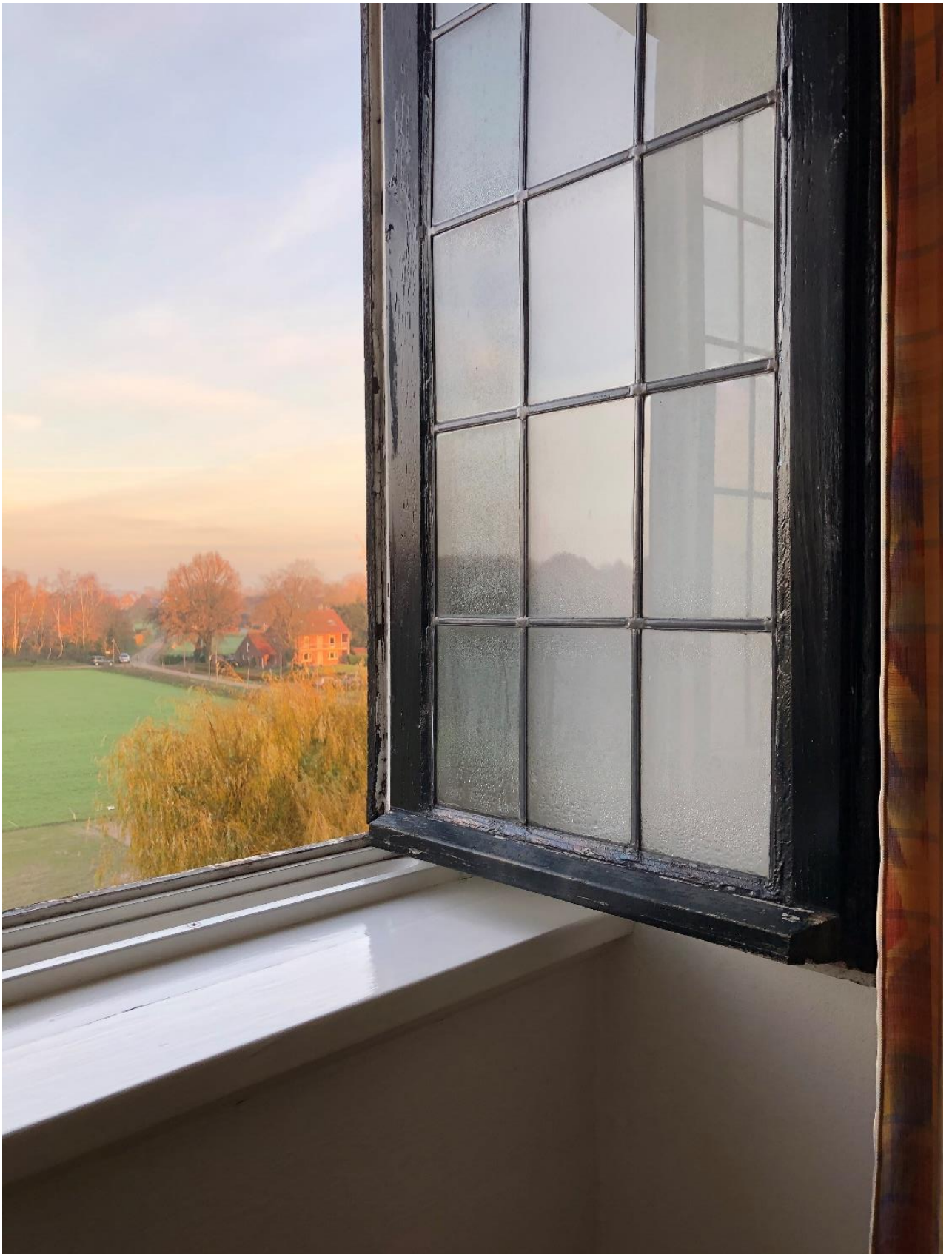
Abbildung 73: Lüften über Fenster ist im Neu- wie im Altbau eine vollumfängliche Option
