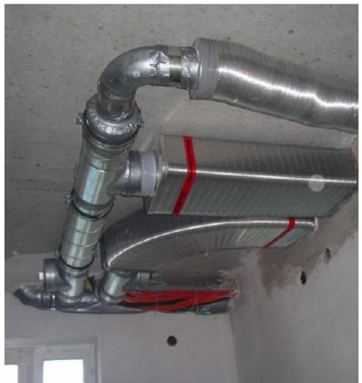
Abbildung 67: Zentrales Zu-/ Abluftsystem mit Wärmerückgewinnung mit Schalldämpfern
