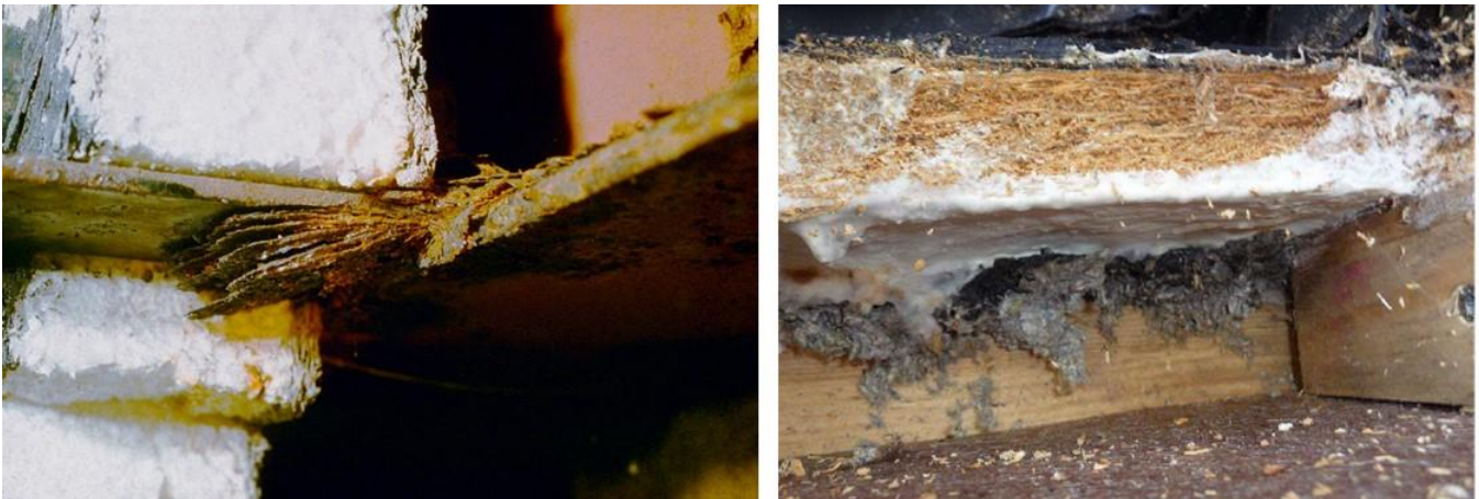
Abbildung 33: fatale Feuchteschäden in Außenbauteilen hervorgerufen durch Konvektionsströmungen: linkes Foto massive Korrosionserscheinungen und rechtes Foto Fäulnis und Schimmelpilzbildung in Bauteilschichten
